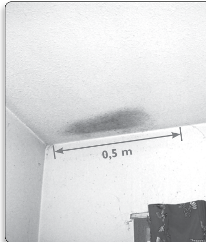
Petite surface de moisissure
