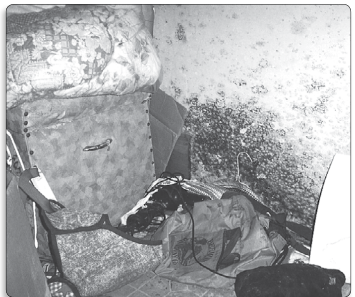
Biens endommagés par la moisissure
