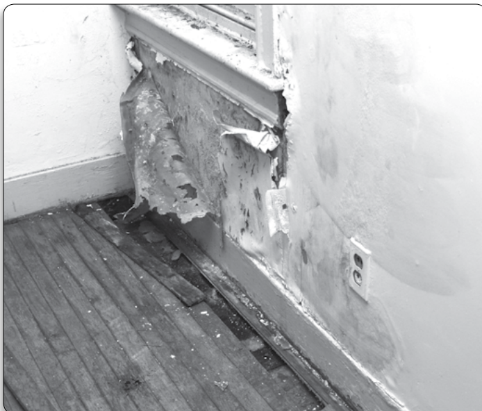
Domages provoqués par l'eau sous une fenêtre
