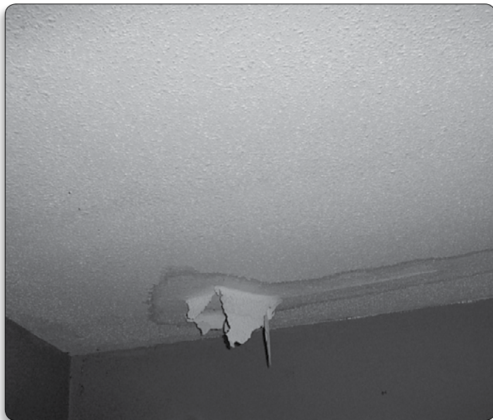
Domages causés par l'eau sur un plafond
