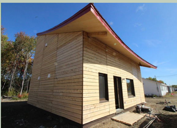
Photo de l'extérieur de la maison qui montre le profil courbé du toit, Mark Hemmings.
