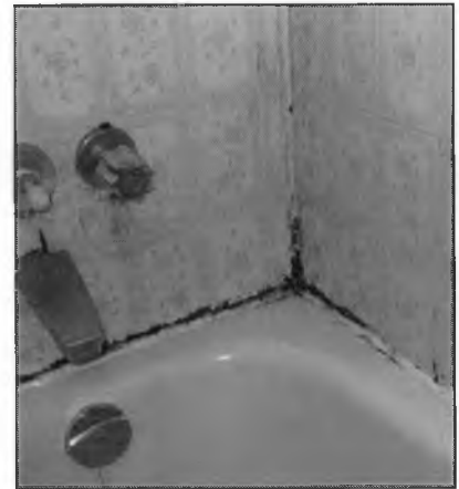
Prolifération des moisissures sur les carreaux de céramique et les joints
