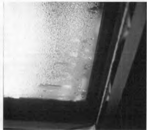
Condensation sur une fenêtre
