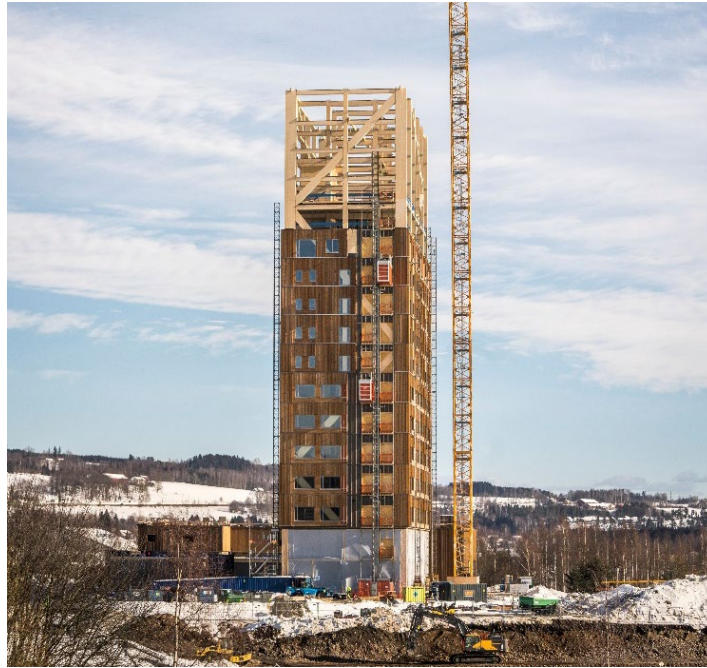
Figure 20. Glulam bracing, Mjøstårnet (courtesy of Moelven Limtre AS & Voll Arkitekter).
